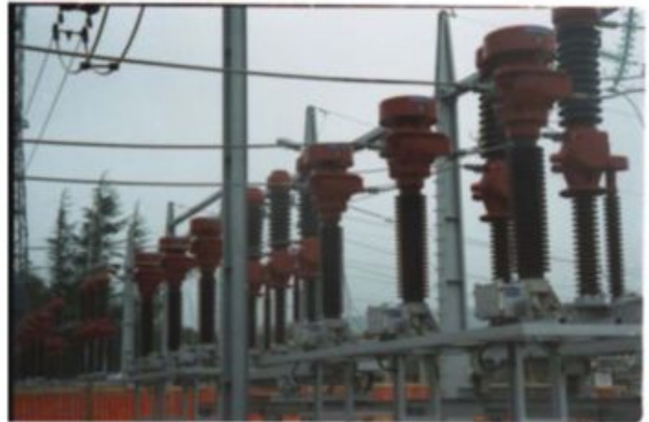
Трансформаторы тока 123 кВ, Словения
