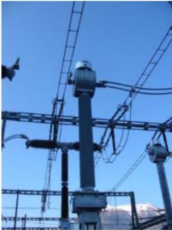
Трансформаторы тока 330 кВ EOS, Швейцария
