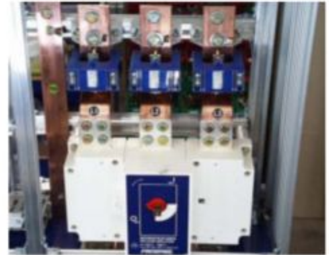
Трансформаторы тока низкого напряжения
