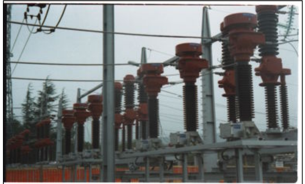
Трансформаторы тока 123 кВ, Словения
