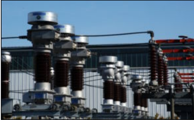
Комбинированные трансформаторы 72 кВ, Швейцария
