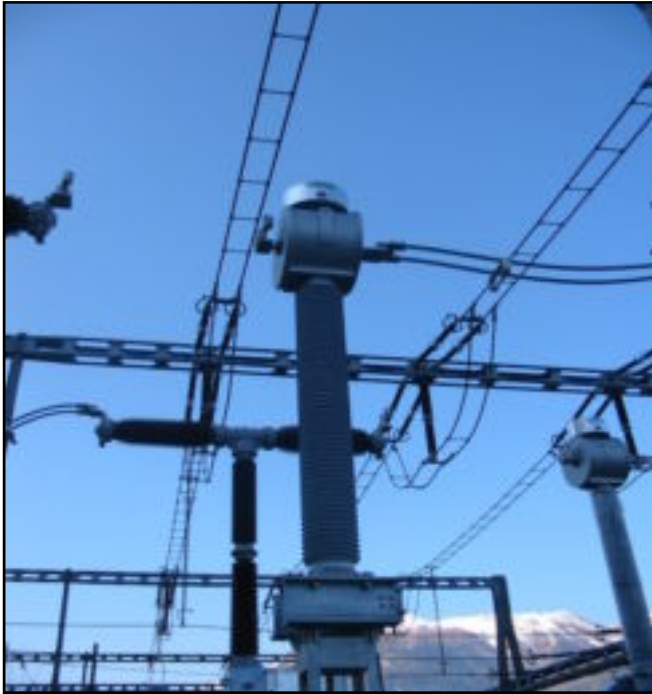
Трансформаторы тока 330 кВ EOS, Швейцария
