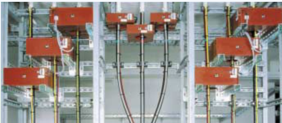
JK im Einsatz in der Anlage IBA, UW Oberentfelden, Schweiz JK in operation at the substation of IBA, S/S Oberentfelden, Switzerland
