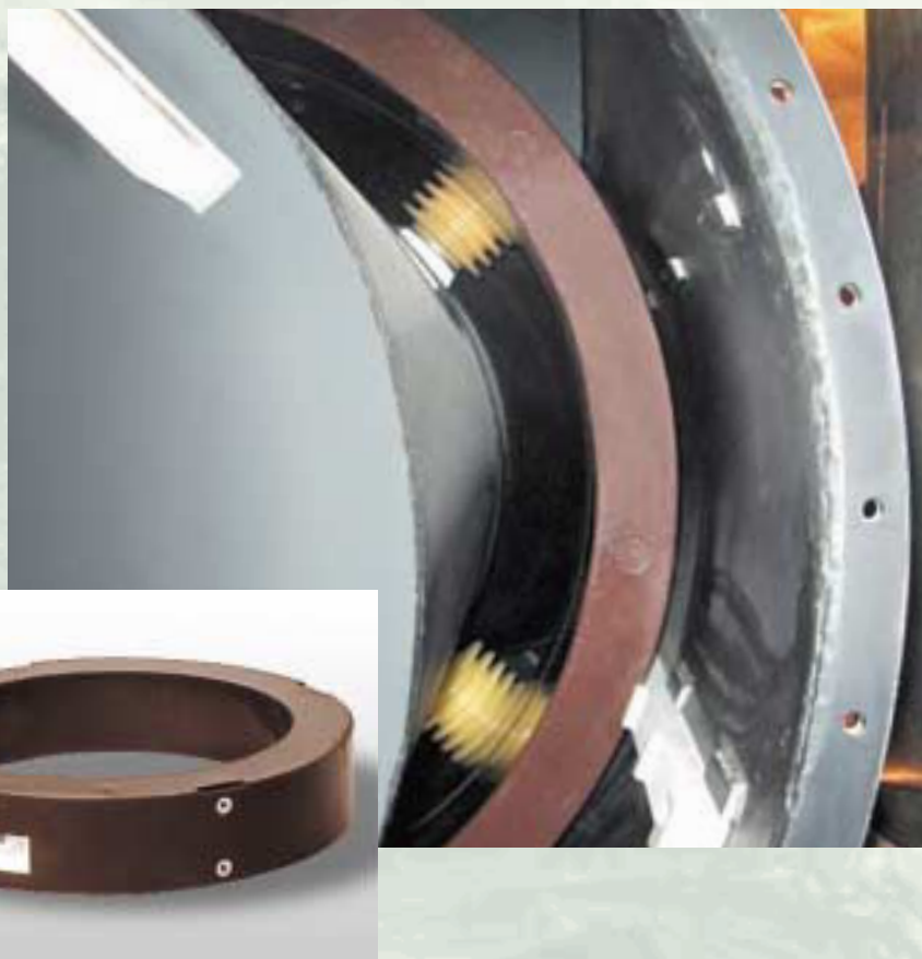
AKA im Einsatz in der Anlage 3 Schluchten, China AKA in operation at the substation of 3 Gorges, China
