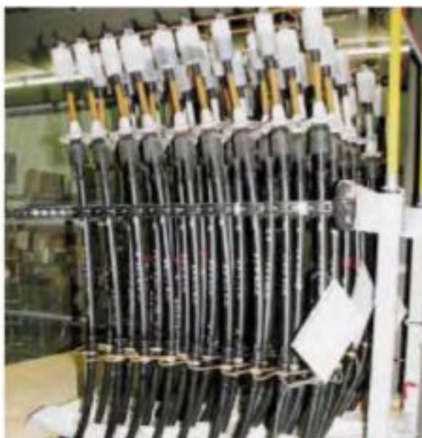
Рис. 3: Установка для длительных испытаний средним напряжением в Brugg
