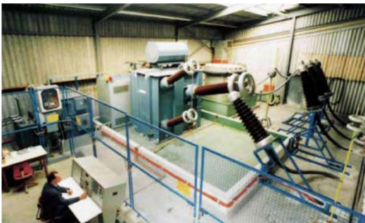
Рис 4: Установка для длительных испытаний высоким напряжением в Birrfeld.
