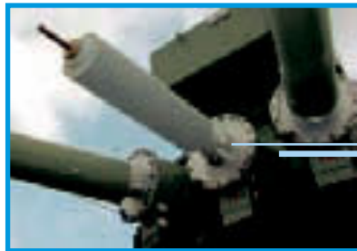
DTOI 123 kV – 1250 A
