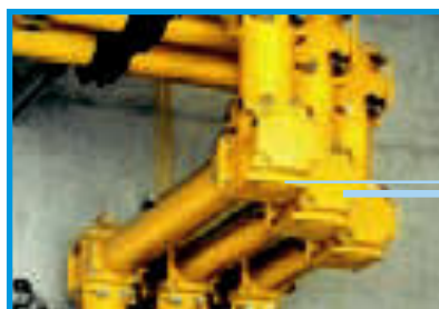
GL 12 kV – 2500 A
