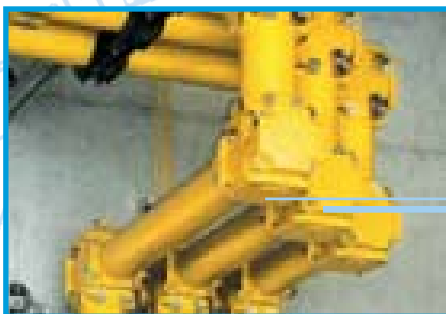
GL 12 kV – 2500 A
