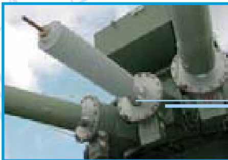
DTOI 123 kV – 1250 A
