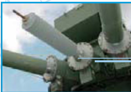
DTOI 123 kV – 1250 A
