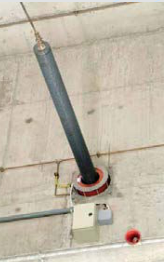
Wanddurchführung Wall bushing Traversée murale 145 kV - 400 A HS Station von La Foretaille, SIG HV substation of La Foretaille, SIG Poste HT de La Foretaille, SIG
