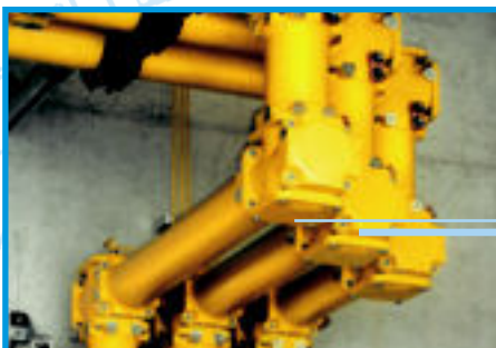
GL 12 kV – 2500 A
